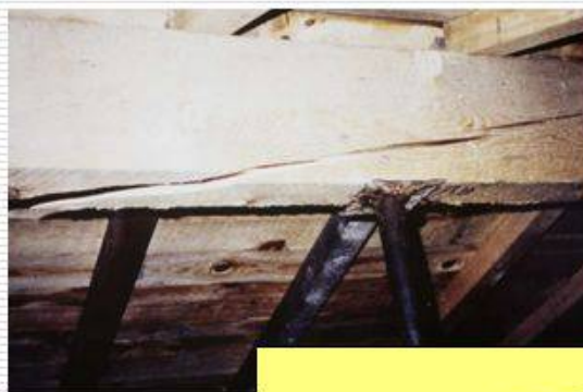
Fissure due à la pente de fil: traction transversale et cisaillement
