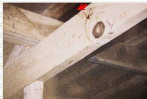
Fissure due à un nœud: déviation du fil du bois, traction transversale et cisaillement
